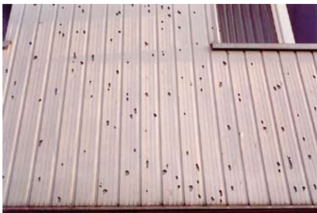
Abbildung 3: Hagelschaden an Kunststofffassade, Wetzikon 2004. (Quelle: Thomas Egli)
