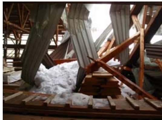
Abbildung 4: Schneedruck verursacht Hallendacheinsturz, Waldstatt 2006. (Quelle: Thomas Egli)
